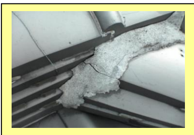
→ 屋根 漆喰、ひび割れ・めくれ ↓
